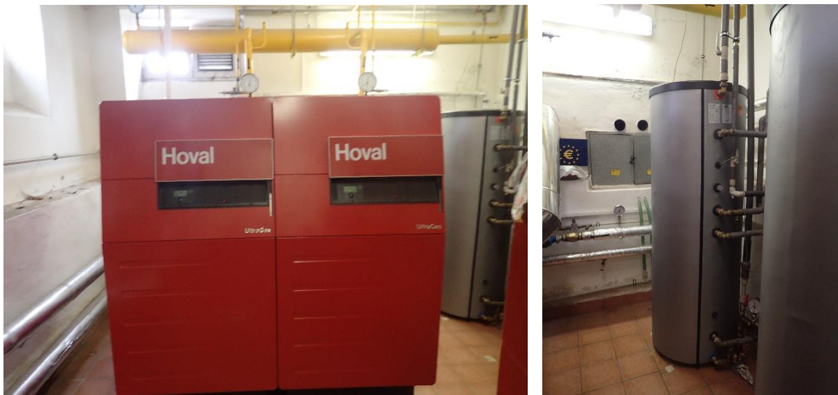
Obrázek 1 Kotelna (stávající kotle a zásobníky TV)
